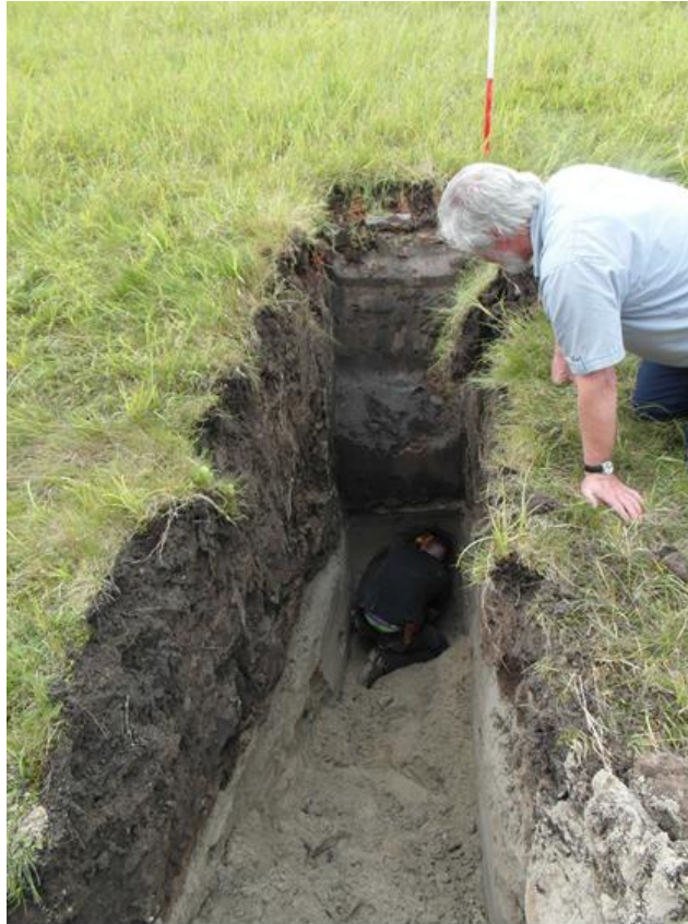
In 2014 uitgegraven vossenhol (9 meter lang) in Gooimeerdijk in Flevoland, door de kleilaag tot in het zand binnen in de dijk
